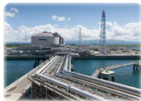
直江津 LNG 基地
